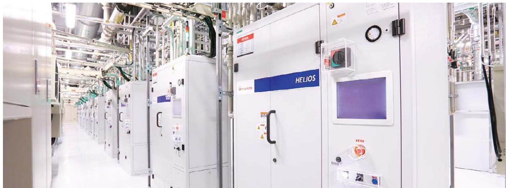
台積公司改造燃燒式現址式處理設備，減少氮氧化物排放
