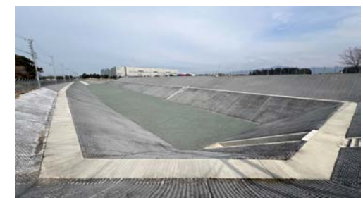
JASM 廠區涵養水工程的涵養池
