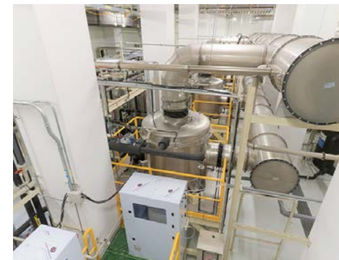
台積公司與供應商合作改造超重力旋轉床設備，增加 IPA 削減率
