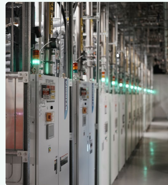
台積電公司改良電熱式現址式處理設備備機待機模式
