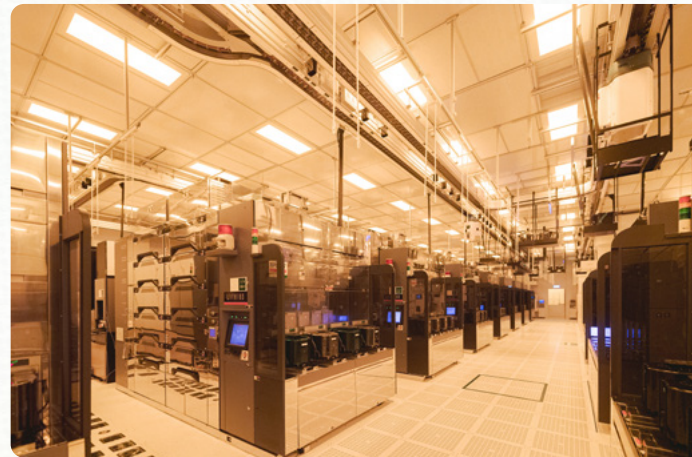
台積公司攜手供應商改良電力變壓器，提升運轉效率
