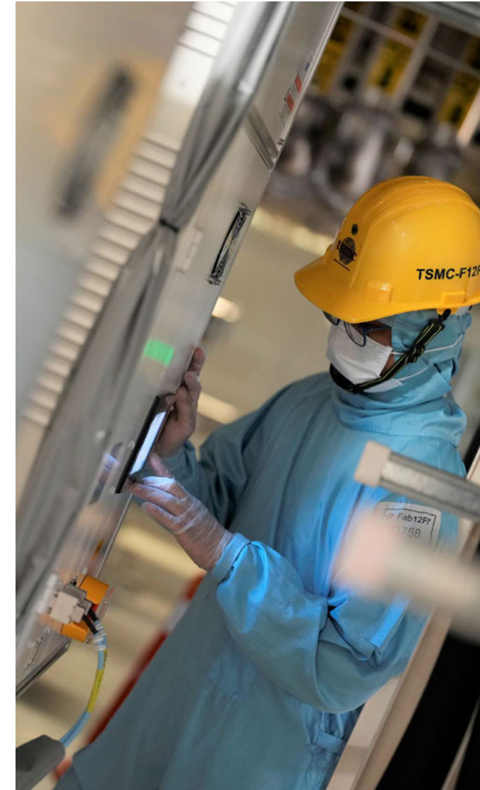
台積公司改造晶圓清洗機台熱水循環系統，提升節能成效
